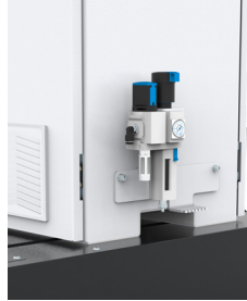
Prepared pneumatic connection and valves | Előkészített pneumatikus csatlakozás és szelepek
